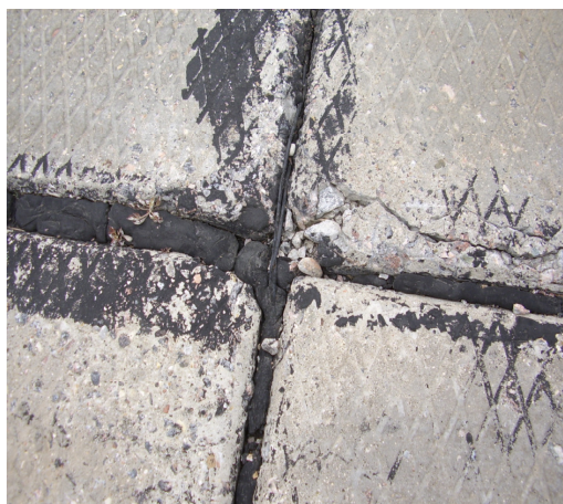
Рис. 1. Разрушение бетонного покрытия ВПП и РД
