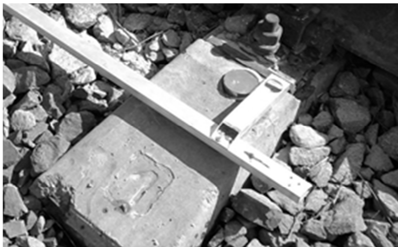
Рис. 2. Магнитная метка, закрепленная на бетонной шпале
